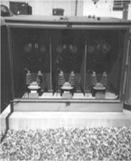
Figura 6-11 Medición primaria subterránea. Cortesía de Alliant Energy.
