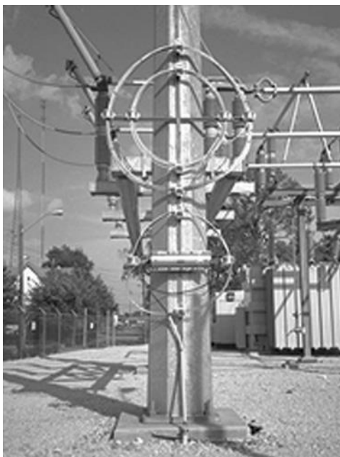
Figura 9-6 Fibra óptica de la subestación.
