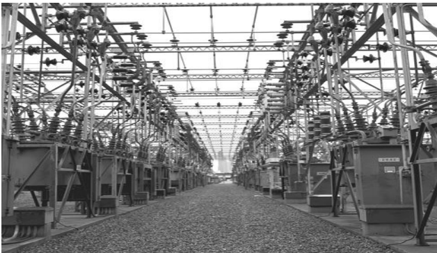
Figura 5-1 Subestación de distribución.
