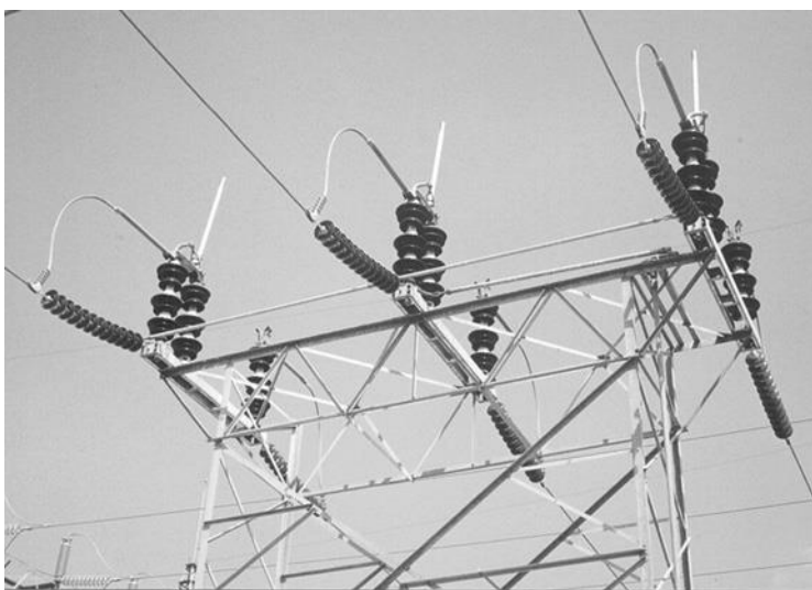
Figura 4-34 Rotura vertical. Cortesía de Alliant Energy.
