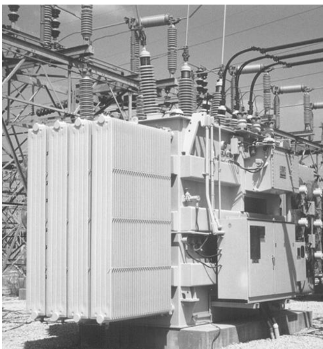
Figura 4-2 Transformador de potencia de distribución.
