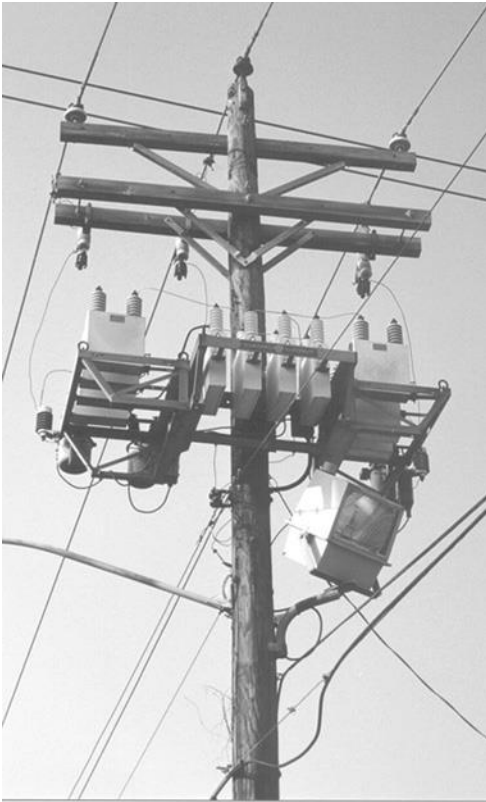
Figura 4-42 Banco de capacitores de distribución.
