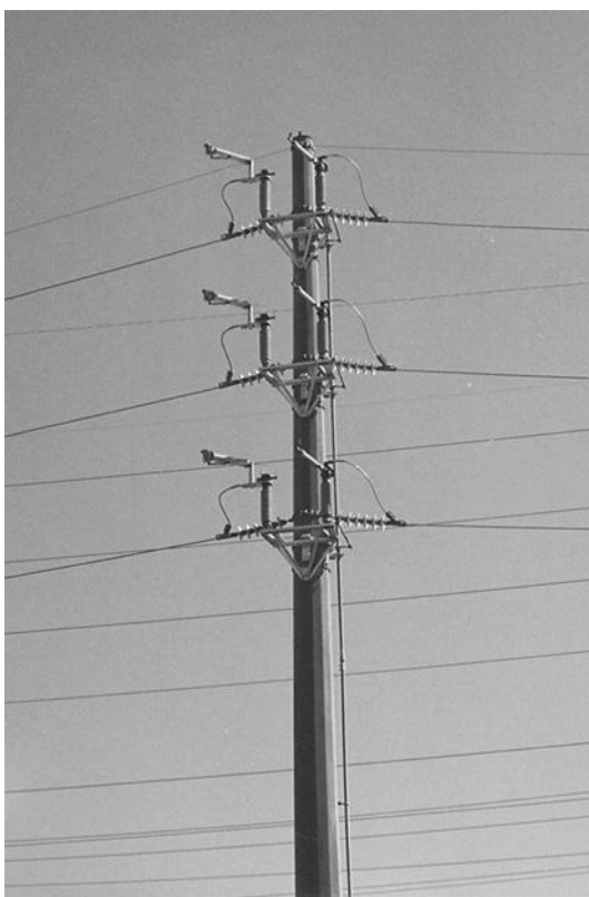
Figura 4-37 Seccionador de línea.
