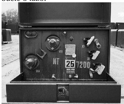
Figura 5-34 Transformador de conmutación. Cortesía de Alliant Energy.
