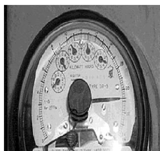
Figura 6-8 Medidor de demanda. Cortesía de Alliant Energy.
