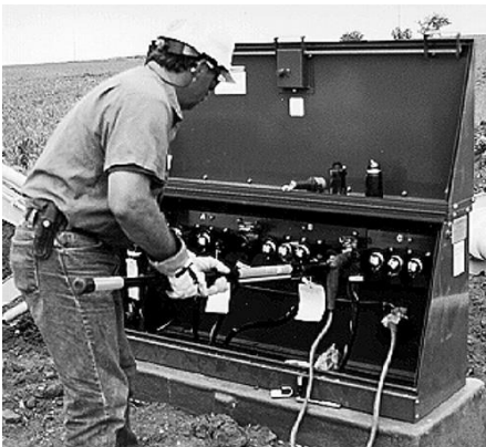
Figura 5-29 Conexiones de ruptura de carga. Cortesía de Alliant Energy.
