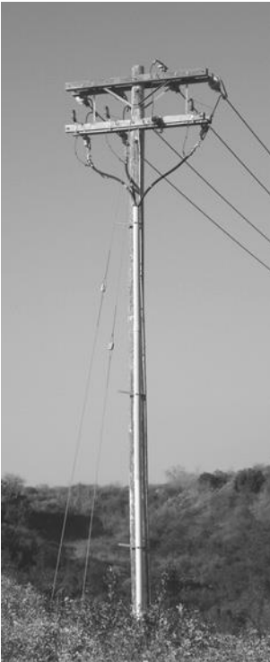
Figura 5-27 Poste de inmersión o poste elevador.
