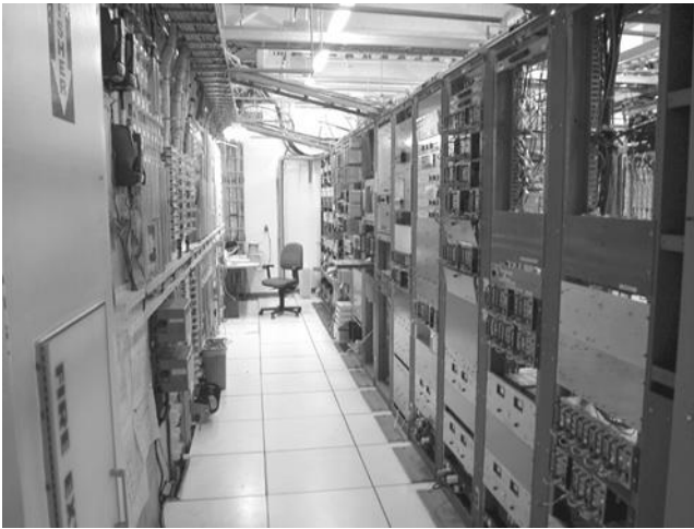
Figura 9-5 Equipo de comunicaciones.
