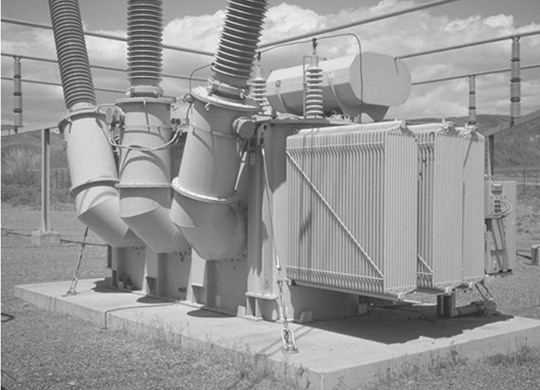
Figura 4-43 Reactor de 345 kV.
