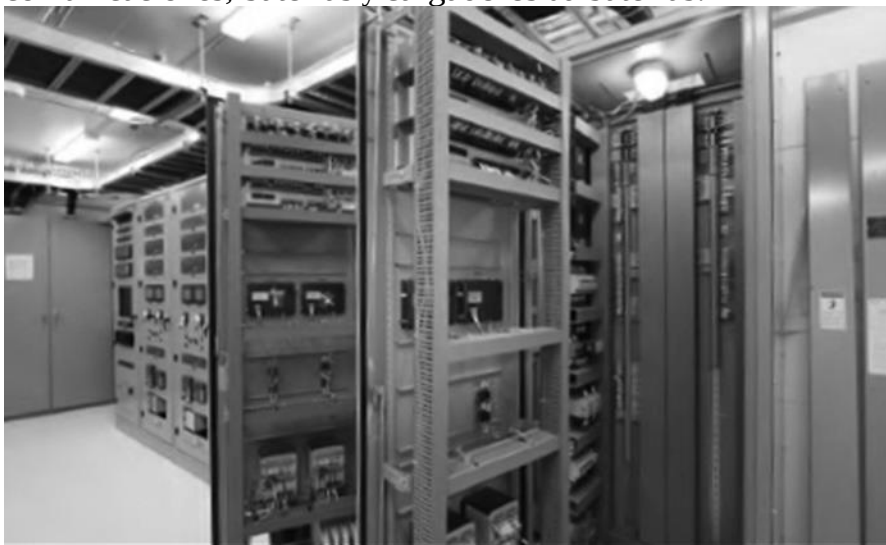
Figura 4-46 Edificio de control. Cortesía de Schweitzer Engineering Laboratories, Inc.
